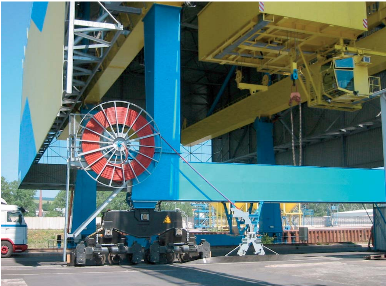
Enrollador de cable a motor LTM 18/38 H4K240-108/MK 78-B en una grúa combinada en el puerto de Andernach con cable de 20 kV. Accionamiento mediante motor trifásico con acoplamiento magnético
