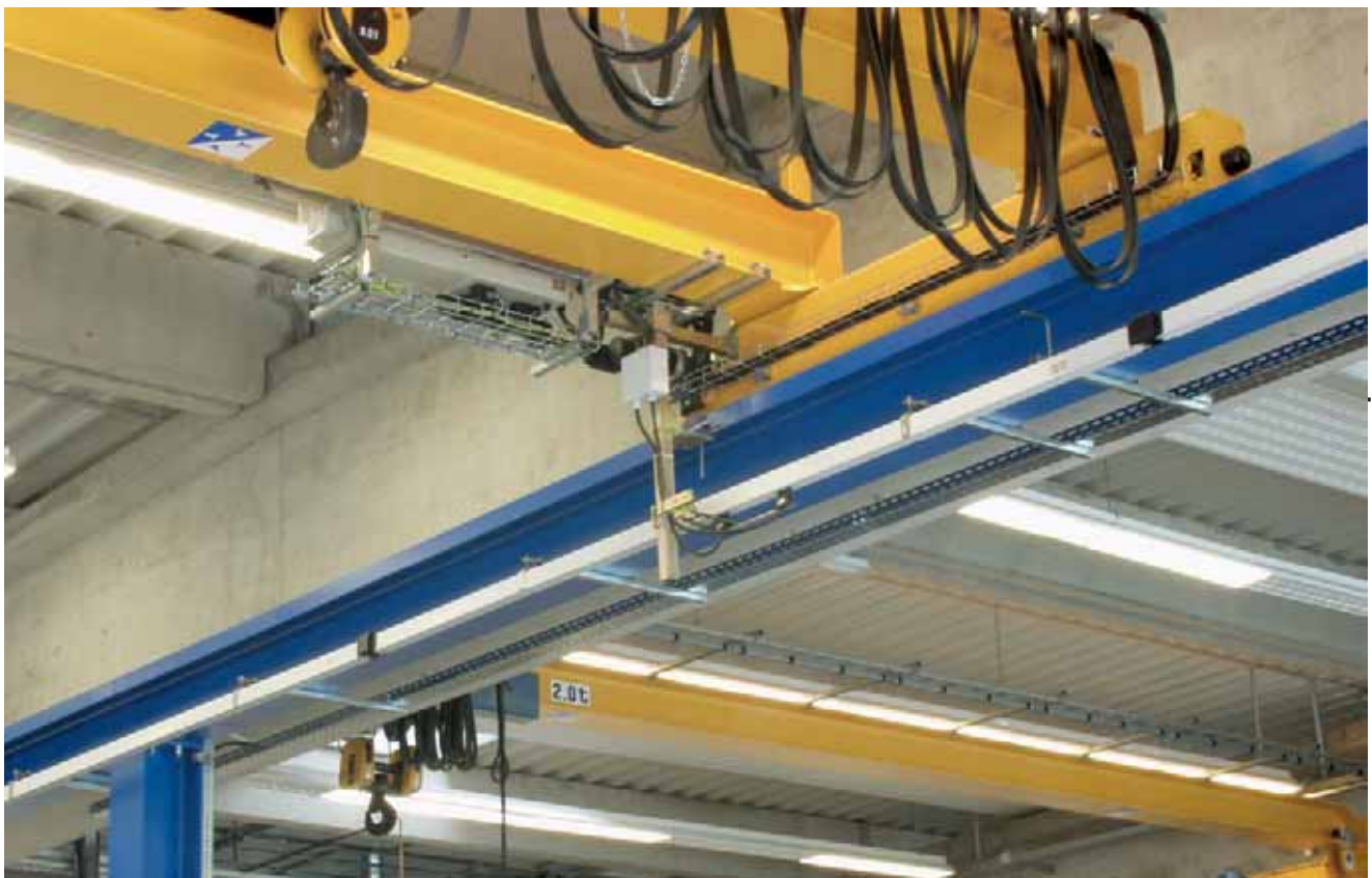
Puentes-grúa en la Firma Rheinmetall Landsysteme (Kiel).
